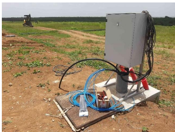
Coffret électrique du réseau de réinjection lixiviats sur dôme casier Nord-Ouest
