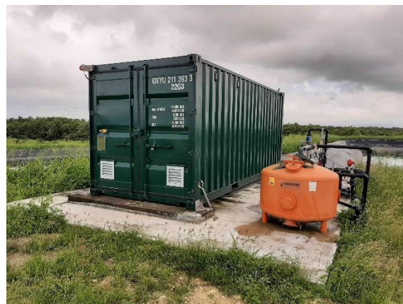
Container process réinjection lixiviats implanté en partie Sud de la zone BRM
