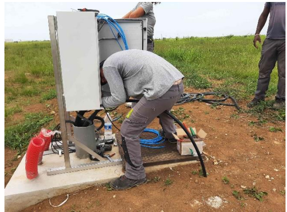
(21/07) Travaux de raccords électriques sur coffret du réseau de réinjection lixiviats casier Nord-Ouest
