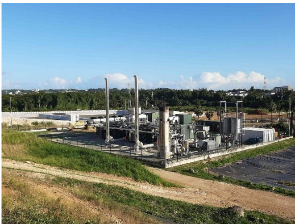
Plateforme biogaz (Unité de cogénération de biogaz + torchère)
