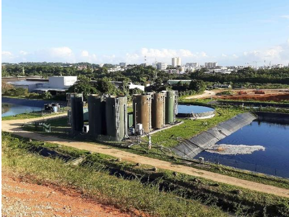
Station BRM de traitement des lixiviats (cuves de biologie + membranes UF/NF)
