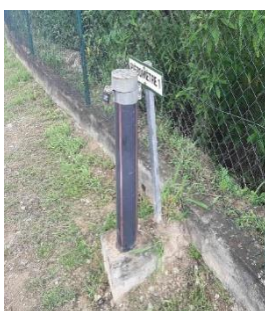
Piézomètre PZ1 en aval hydraulique
