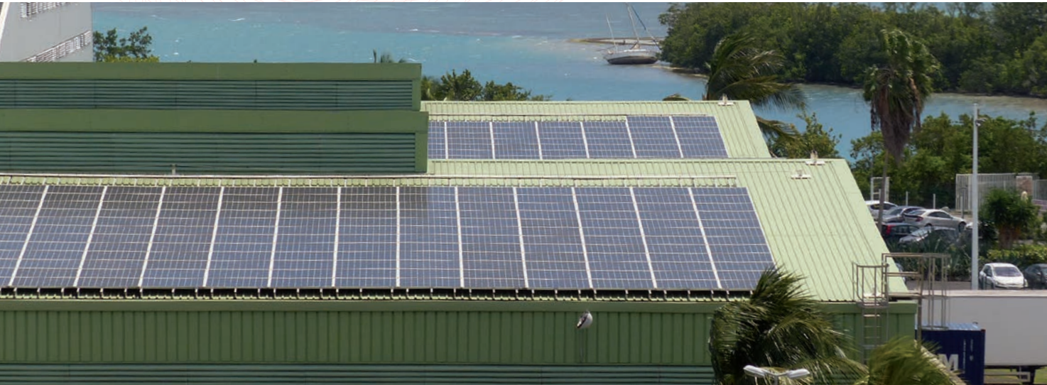
Centrale photovoltaïque sur toiture
