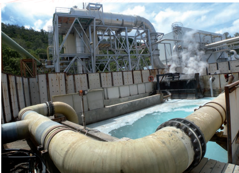
Bassin de refroidissement du fluide géothermal
